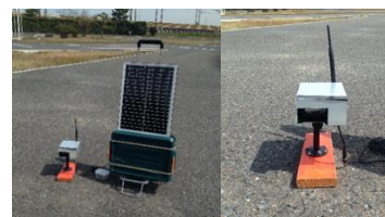
図 2. 移動式電源 (自作) と カメラの設置状況
