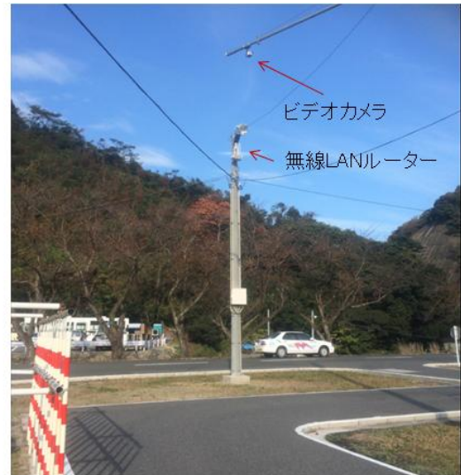
Figure 1. 俯瞰ビデオカメラの設置状況。
