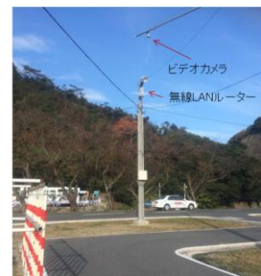
Figure 1. 俯瞰ビデオカメラの設置状況.
